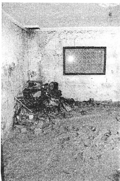
Partout des poêles en faïence qui n'ont pas résisté à un bain prolongé dans l'eau
